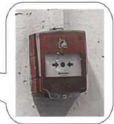
Pulsador de Emergencia
